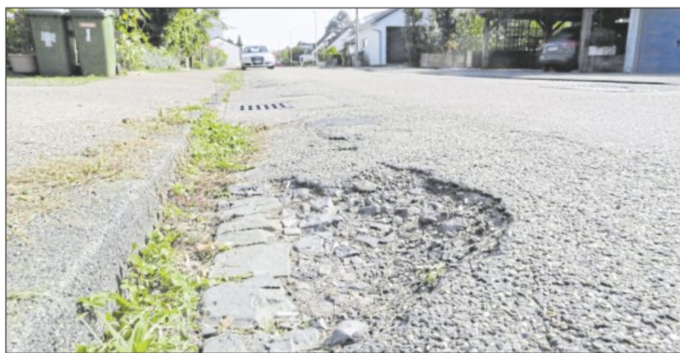
Die Vaihinger Friedrich-Kraut-Straße ist in einem schlechten Zustand. Jetzt ist ein Vollausbau geplant. Foto: Arning
